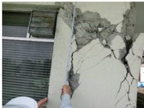
外来臨床研究棟 柱ひびわれ
