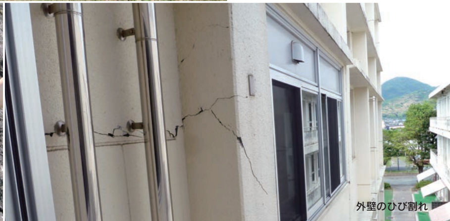
擁壁法面のひび割れ
